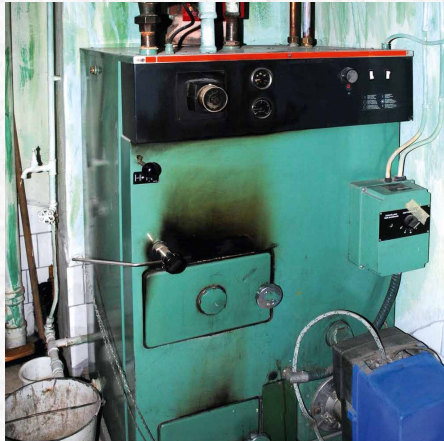
Der Austausch der alten Heizung muss noch warten, bis alle Fragen zum Energieerneuerungsgesetz geklärt sind
